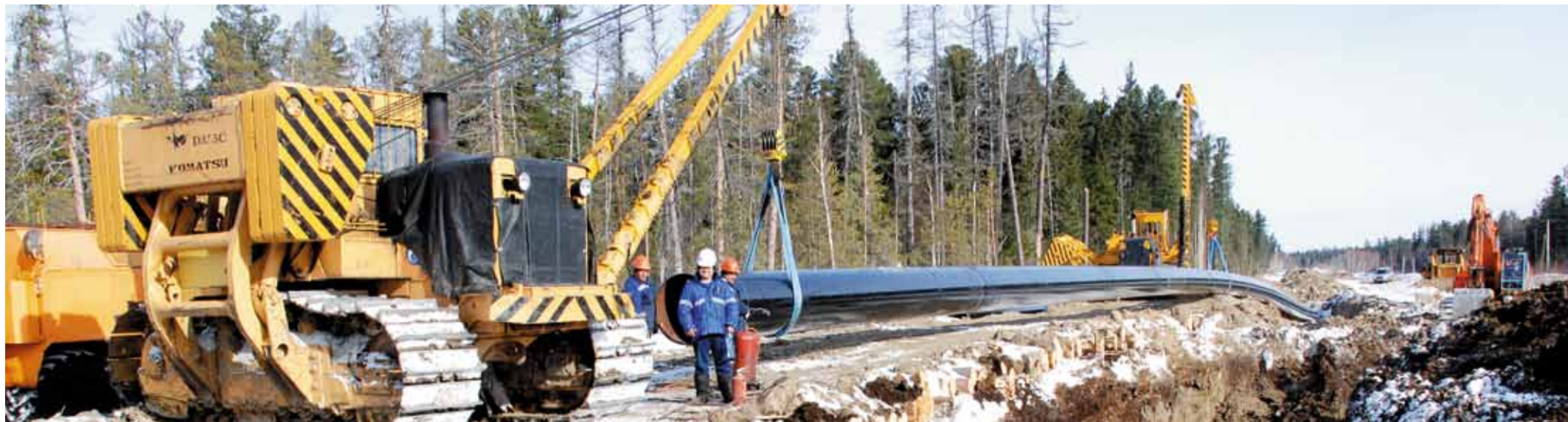
Проведение комплекса ремонтных работ – один из главных факторов, обеспечивающих бесперебойную подачу газа потребителям
