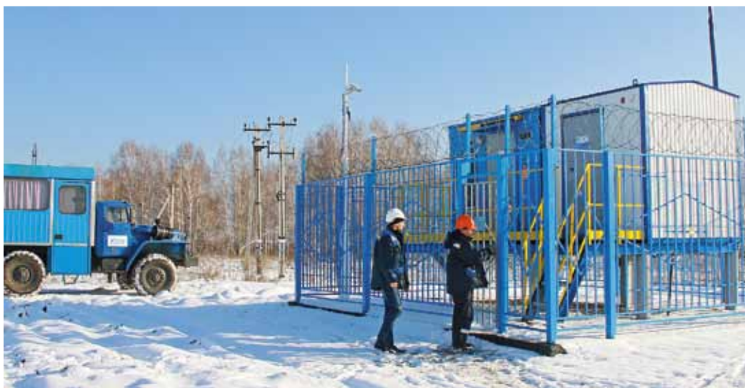
Так выглядит контрольный пункт ЭХЗ после реконструкции
